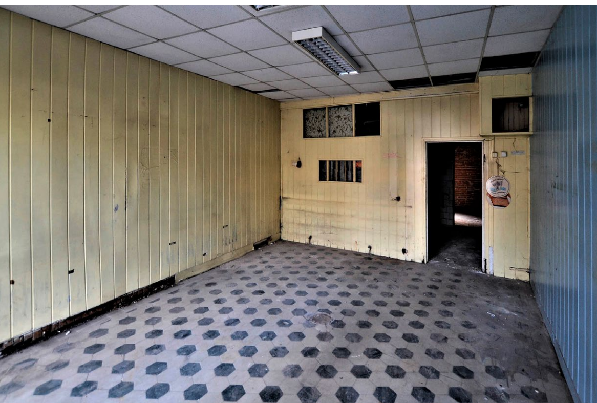
Wnętrze lokalu przy ul. Traugutta 77 - przed i po remoncie. Fot. Lucyna Maury, Wrocławska Rewitalizacja
