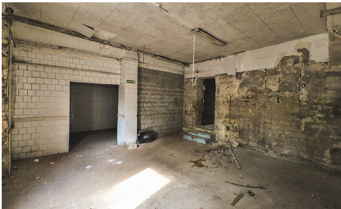
Wnętrze lokalu przy ulicy Traugutta 77 przed remontem. Fot. Lucyna Maury, Wrocławska Rewitalizacja
