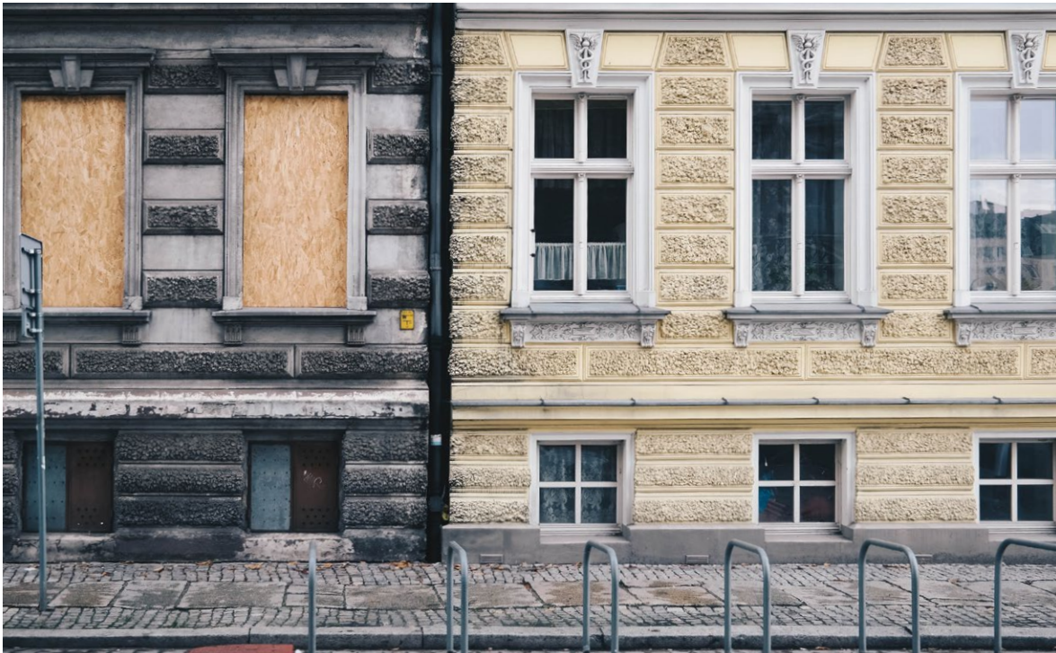
Elewacje frontowe ze względu na ich bogate zdobienia nie zawsze mogą być ocieplane od zewnątrz. Tym bardziej ważne jest zastosowanie tutaj materiałów remontowych dobrej jakości i dobrze wykonanej, szczelnej stolarki. Fot. Paweł Wojdyłak, Wrocławska Rewitalizacja
