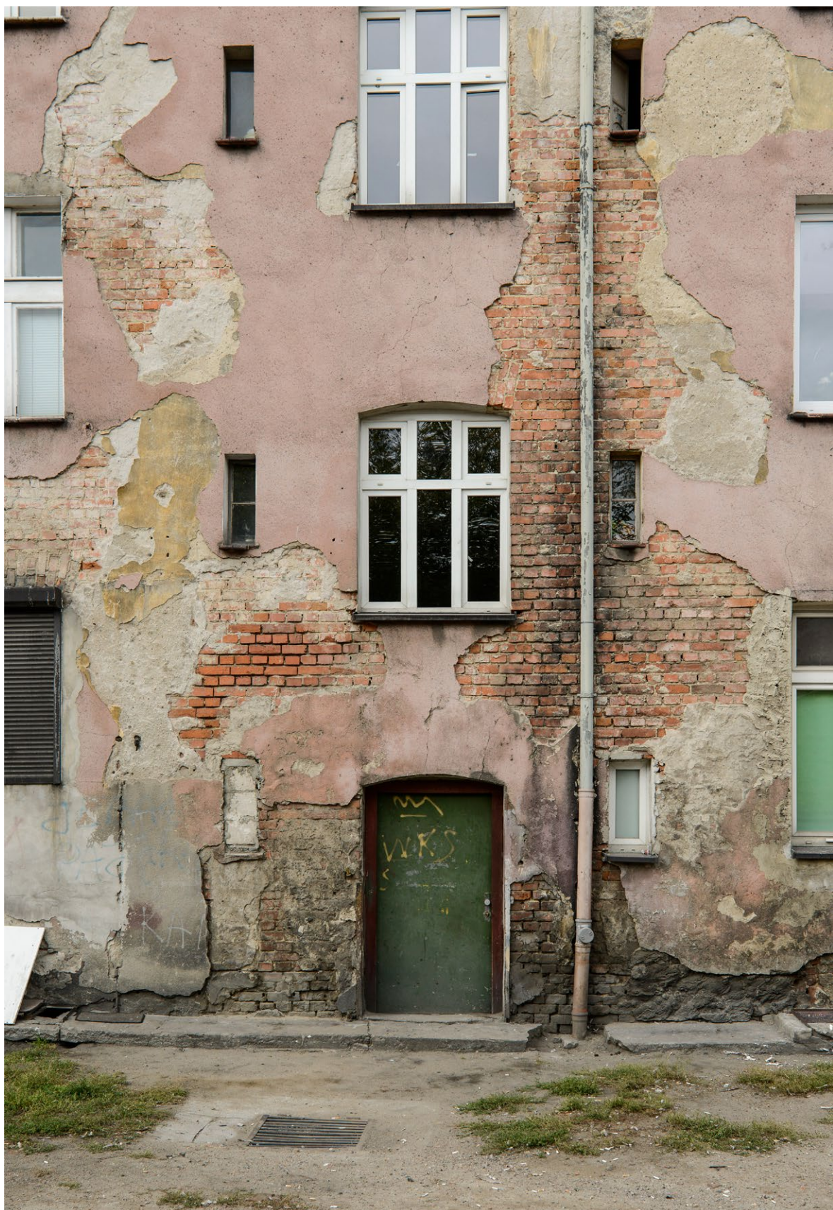
Woda i wilgoć to najwięksi wrogowie kamiec. Wieleletnie zaniedbania powodują degradację i wysokie koszty remontów. Fot. Artur Busz, Wrocławska Rewitalizacja
