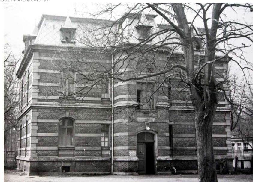
Fot. 5: Willa, stolarka drzwiowa, ul. Związku Walki Młodych 4 (obecnie Armii Krajowej). Widok od pd.-wsch.
