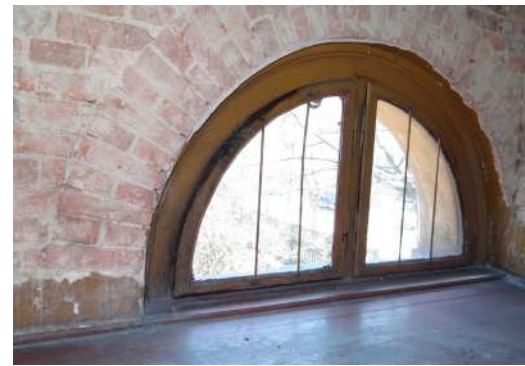
Fot. 2: Stolarka drzwiowa, typ D-02. Widok naświetla (widok od wewnątrz).
