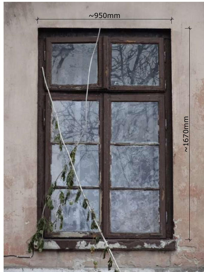
Fot. 1: Stolarka okienna, typ O-05. Widok z podstawowymi wymiarami stolarki (widok zewnętrzny).
