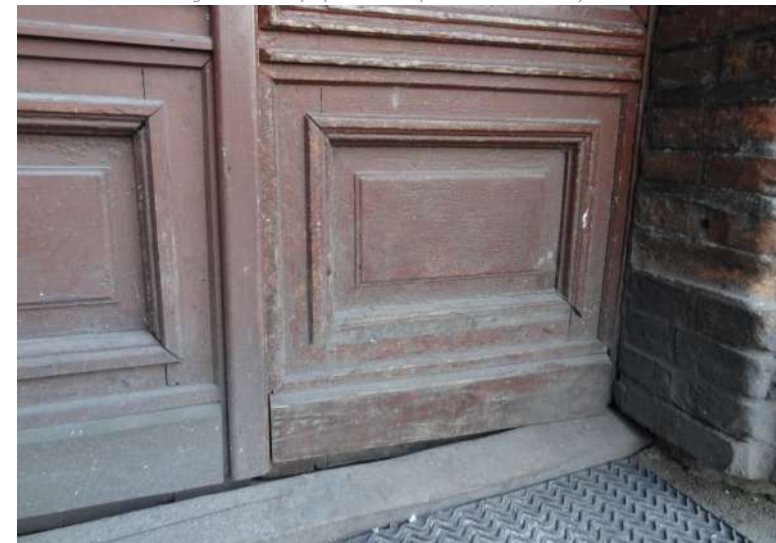
Fot. 3: Stolarka drzwiowa, typ D-05. Detal. Źródło: Fotografia. Autorzy opracowania (OUTIN Architektura).
