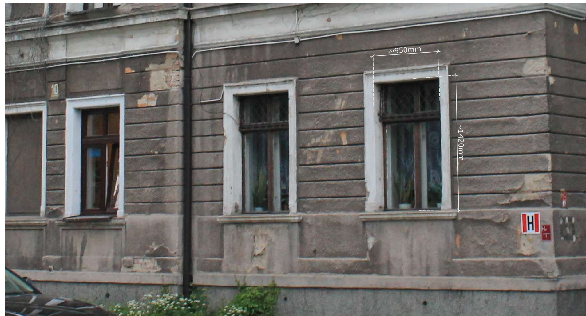
Fot. 3: Stalarka okienna, typ O-67. Widok z podstawowymi wymiarami stolarki. Źródło: Fotografia. Autorzy opracowania (OUTIN Architektura)
