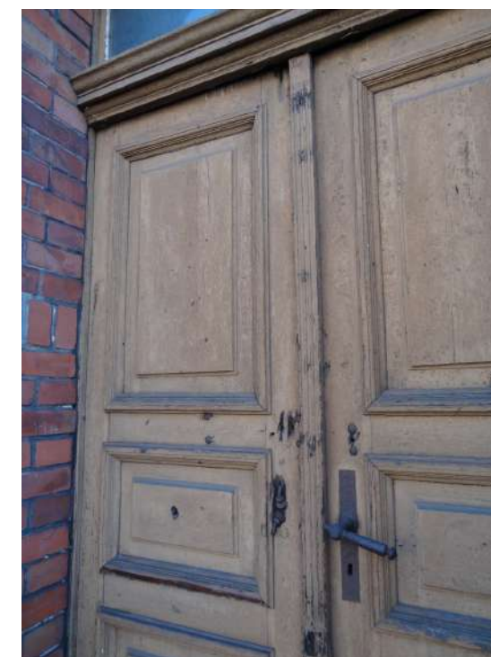
Fot. 3: Stolarka drzwiowa, typ D-09. Detal: płyciny (flag, kaseton) widok od zewnątrz.
