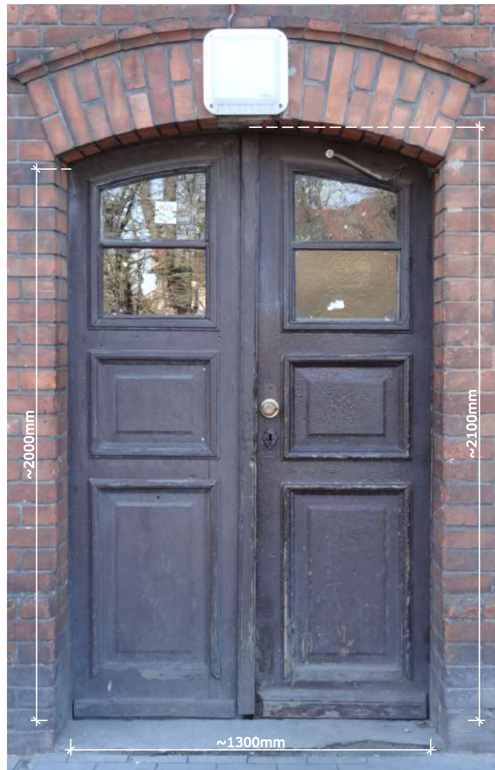
Fot. 1: Stolarka drzwiowa, typ D-06. Widok front (zewnętrzny) z podstawowymi wymiarami stolarki. Źródło: Fotografia. Autorzy opracowania (OUTIN Architektura).
