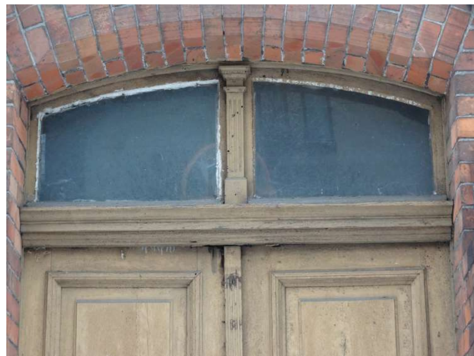
Fot. 5: Stolarka drzwiowa, typ D-09. Detal: naświetle ze stałym słupkiem oraz profilowana belka ślimienna.
