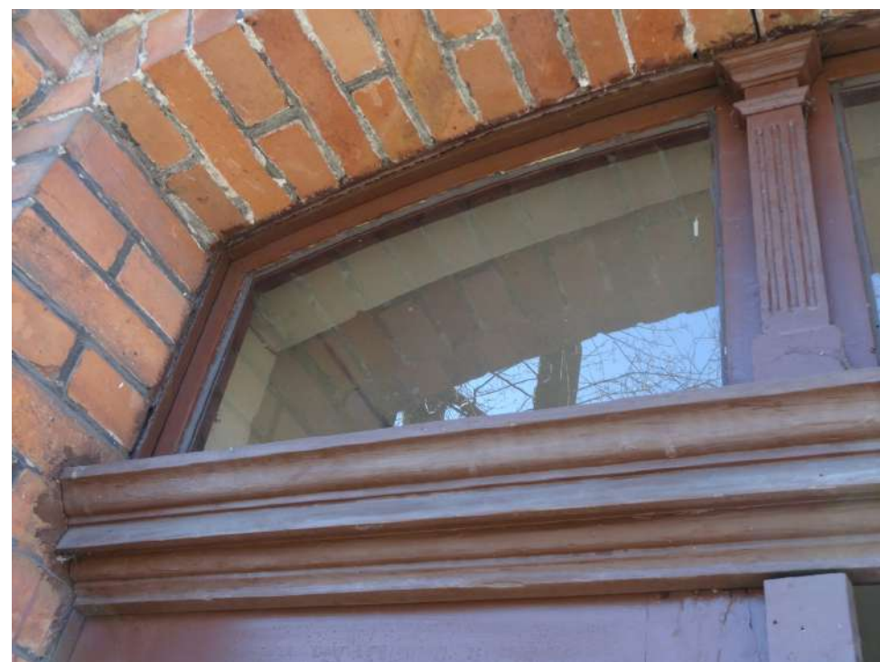
Fot. 2: Stolarka drzwiowa, typ D-09. Detal: naświetle ze stałym słupkiem oraz profilowana belka ślimienna.
