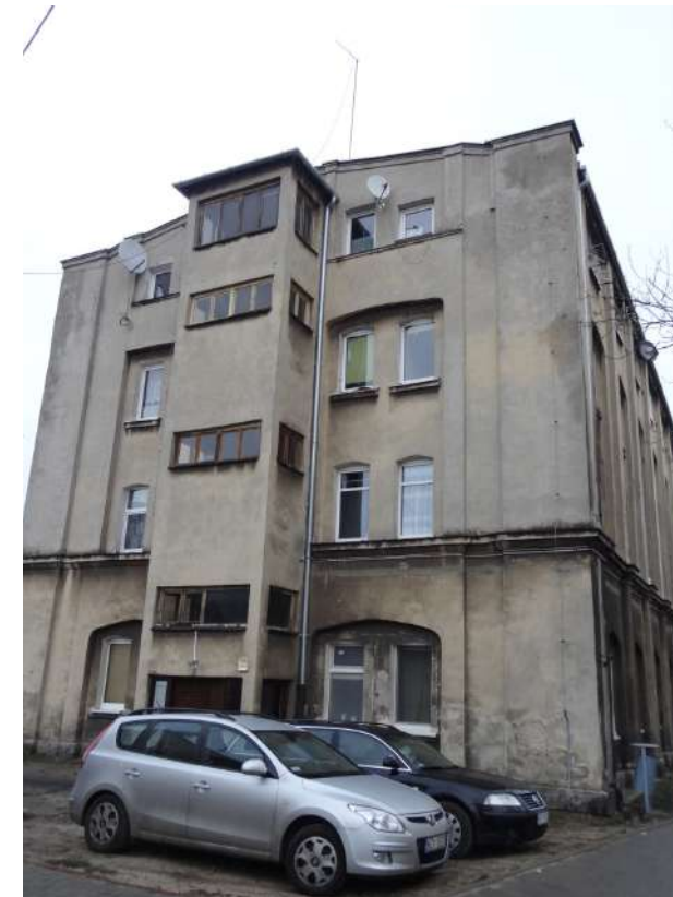
Fot. 2: Budynek przy ul. Mireckiego 70. Fragment elewacji ściany szczytowej z lokalizacją stolarki okiennej.
