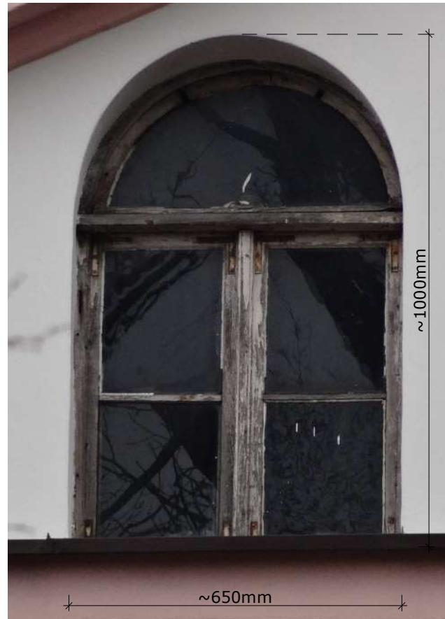
Fot. 1: Stolarka okienna, typ O-62. Widok z podstawowymi wymiarami stolarki. Źródło: Fotografia. Autorzy opracowania (Out In Architektura).
