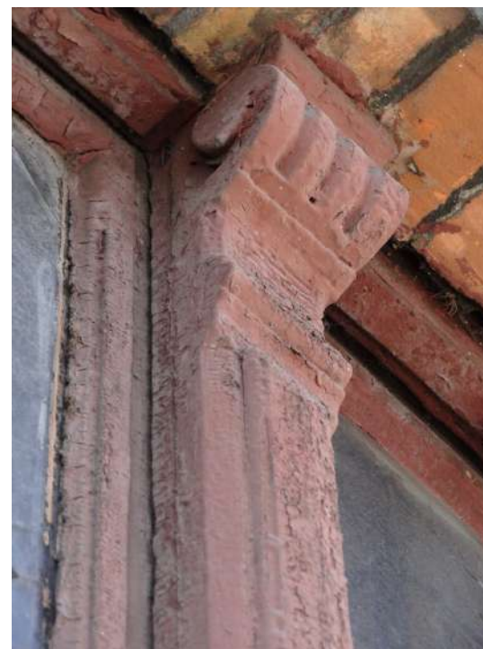
Fot. 5: Stolarka drzwiowa, typ D-13. Detal: słupek naświetla. Źródło: Fotografia. Autorzy opracowania (OUTIN Architektura).
