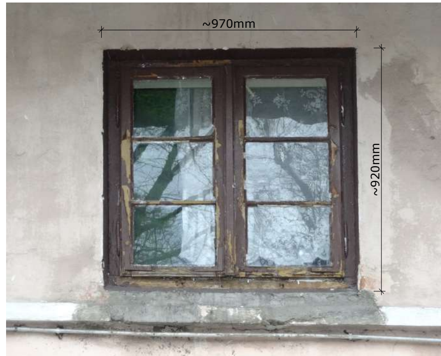
Fot. 1: Stolarka okienna, typ O-06. Widok z podstawowymi wymiarami stolarki (widok zewnętrzny).
