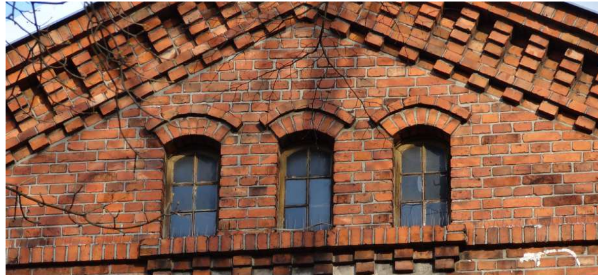
Fot. 1: Stolarka okienna, typ O-23. Widok. Źródło: Fotografia. Autorzy opracowania (OUTIN Architektura).
