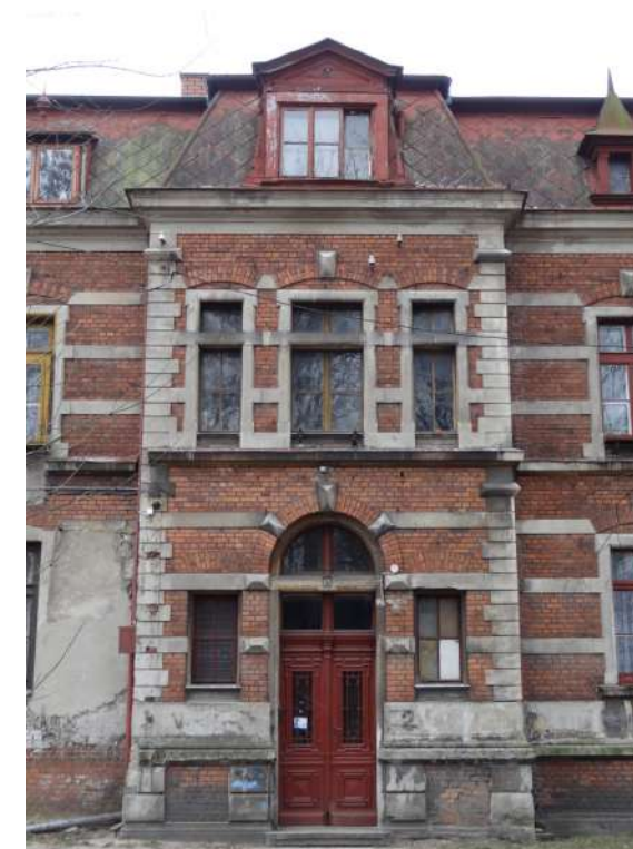
Fot. 4: Stolarka okienna, typ O-21. Fragment elewacji. Źródło: Fotografia. Autorzy opracowania (OUTIN Architektura).
