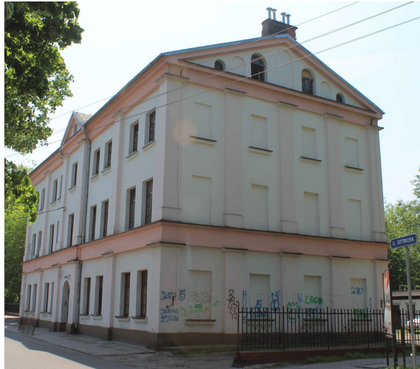
Fot. 3: Budynek przy ul. Dittricha 3. Widok od strony północnej Źródło: Fotografia. Autorzy opracowania (OUTIN Architektura).
