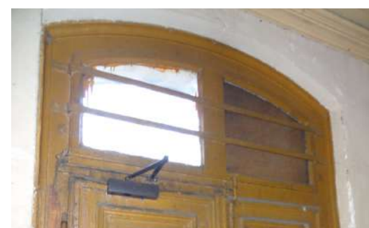
Fot. 2: Stolarka drzwiowa, typ D-01. Widok naświetla (widok od wewnątrz).
