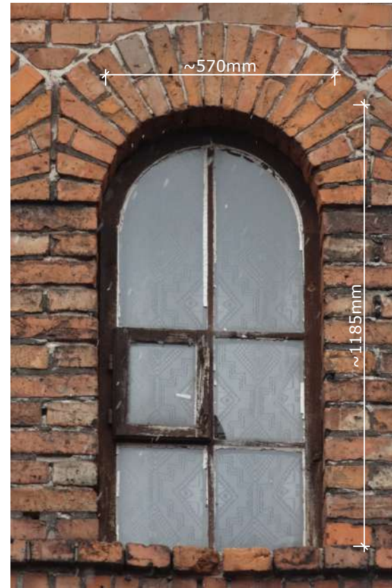
Fot. 1: Stolarka okienna, typ O-10a. Widok z podstawowymi wymiarami stolarki (widok zewnętrzny).
