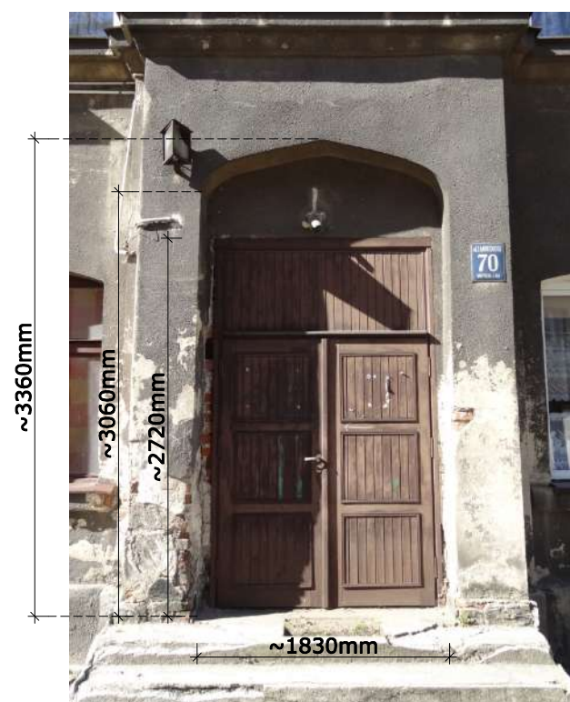
Fot. 1: Stolarka drzwiowa, typ D-21. Widok front (zewnątrzny) z podstawowymi wymiarami stolarki.
