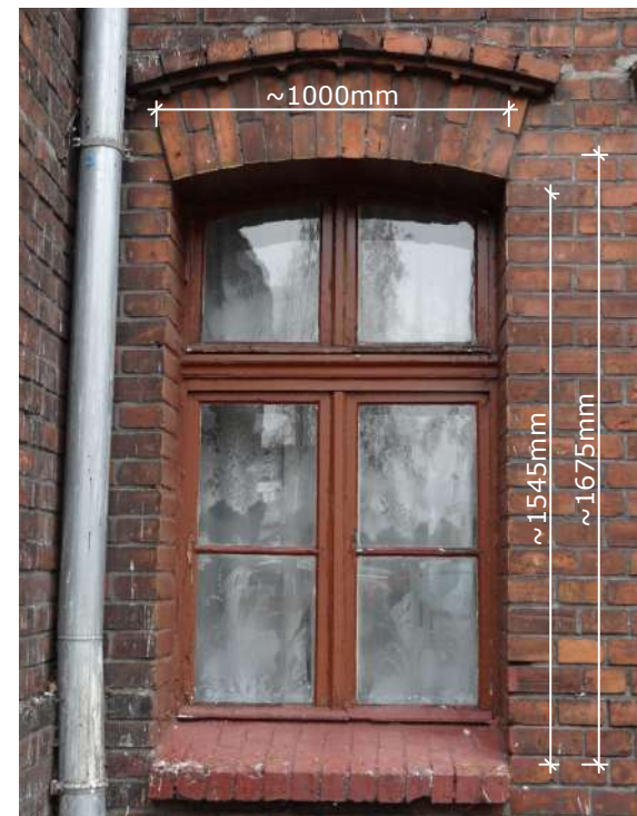
Fot. 1: Stolarka okienna, typ O-07. Widok z podstawowymi wymiarami stolarki (widok zewnętrzny).
