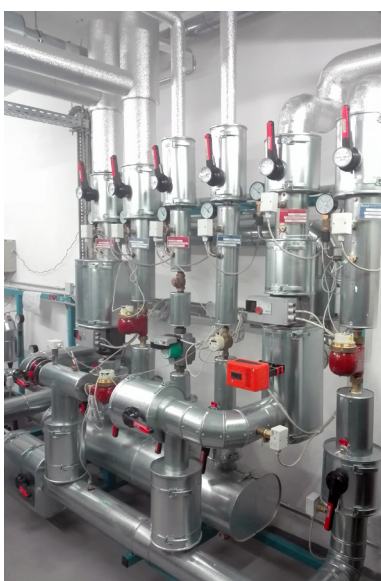
Fot. 13. Rozdzielacz ogrzewania dla grzejników i wentylacji z przepływomierzami Źródło: Instytut Rozwoju Miast i Regionów.
