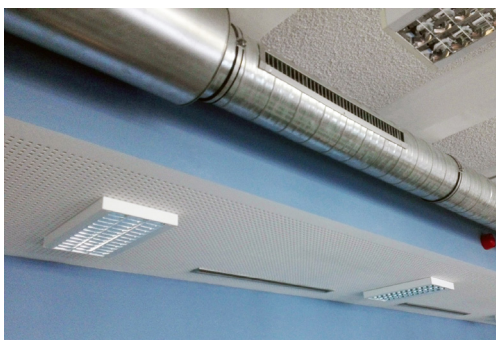
Fot. 11. Wywiew powietrza z pomieszczenia, nawiew powietrza do pomieszczenia Źródło: Instytut Rozwoju Miast i Regionów.
