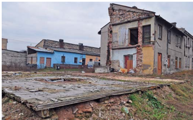
Ryc. 36. Niszczące budynki na Wierzbniku
