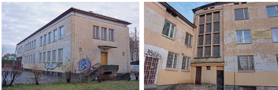
Ryc. 37. Dawny, niszczący budynek starostwa powiatowego
