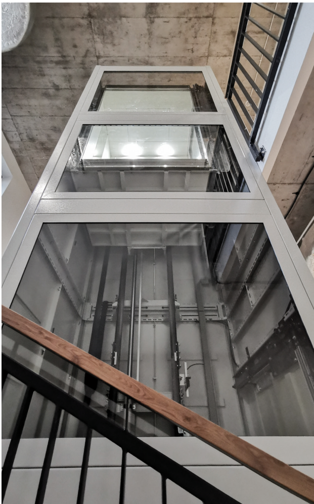
Fot. 2 Platforma z szybem samonośnym w duszy klatki schodowej, archiwum Global Lift Polska
