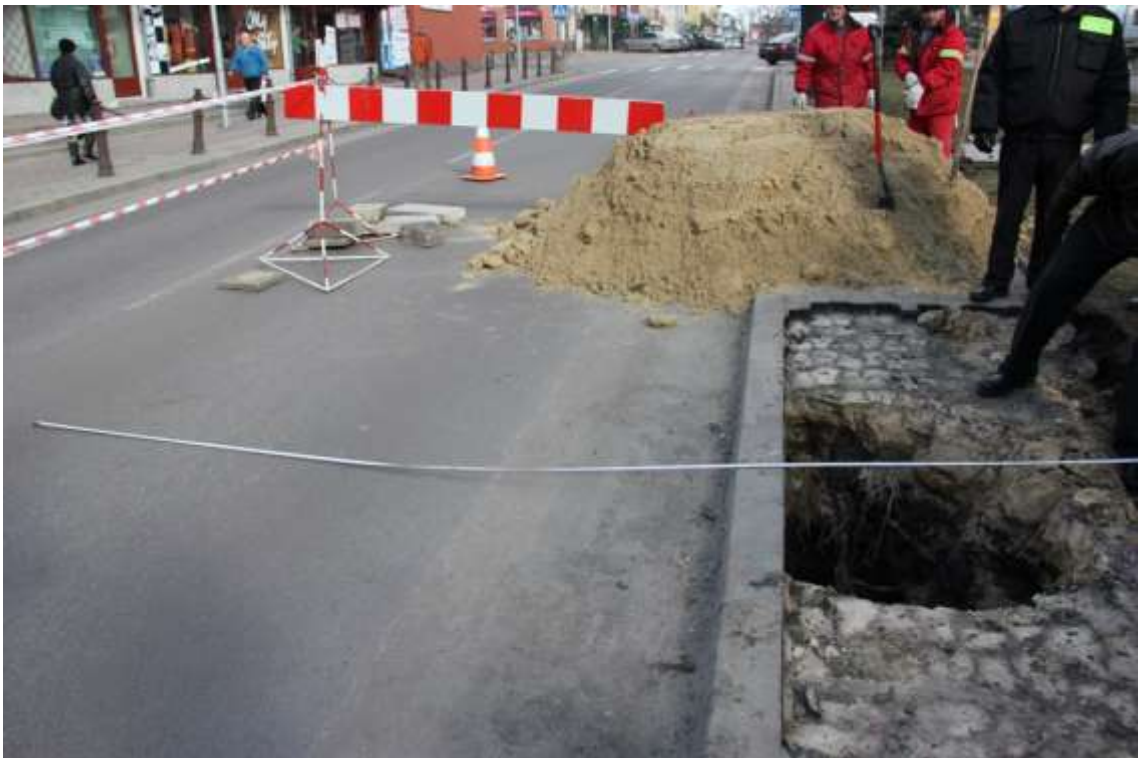
Fot .5. Obszar zapadnięcia podbudowy drogi w rejonie Placu Wolności /fot. Ł.Krawczyk/
