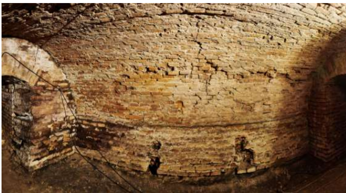
Fot.10. Poprzeczne pęknięcie stropu komory oraz szczelina pod murem na poziomie spągu komory po jezdnię wojewódzką /fot. P.Drechsler/
