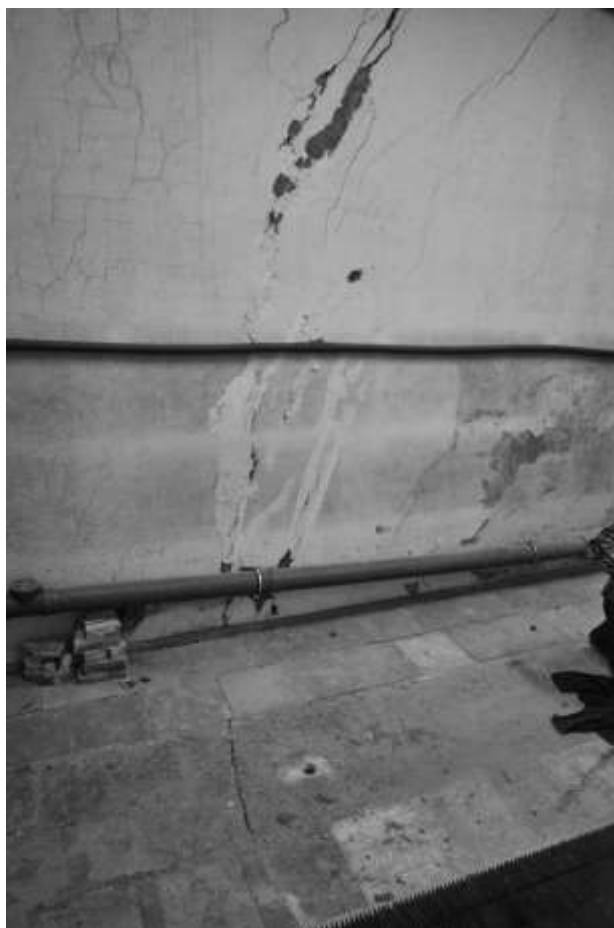
Fot.8. Sieć spękań w piwnicach i parterze kamienicy przy placu Wolności 8 /fot. P.Drechsler/
