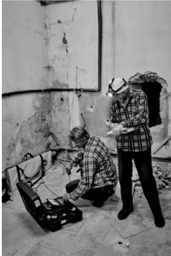
Fot.6. Inwentaryzacja, pomiary, badania i opis pustek objętych i sąsiadujących z planowanym przebiegiem Trasy Turystycznej /fot. P.Drechsler/
