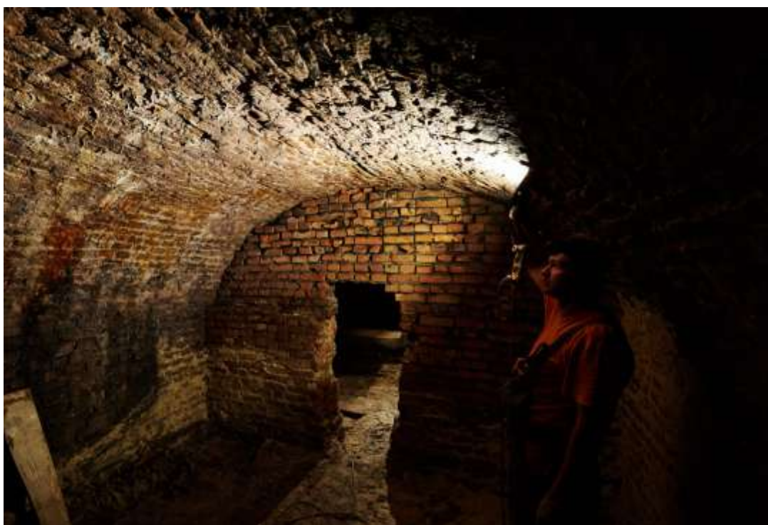
Fot.9. Pas nowego sklepienia ceglanoego zabudowanego w miejsce starszego, uszkodzonego wraz z nową poszerzającą się szczeliną wzdłuż tego pasa /fot. P.Drechsler/
