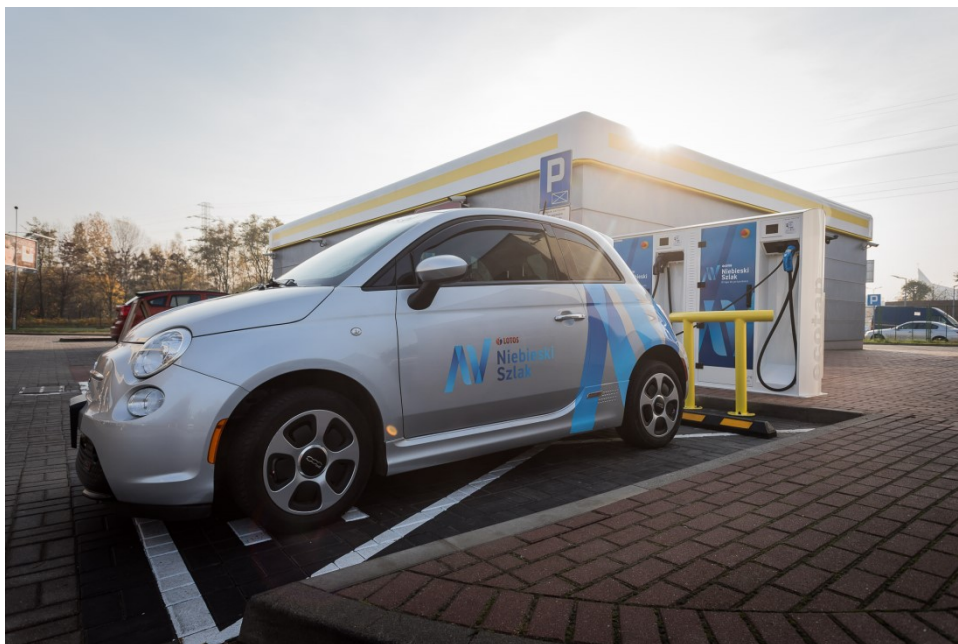
Stacja ładowania pojazdów elektrycznych
