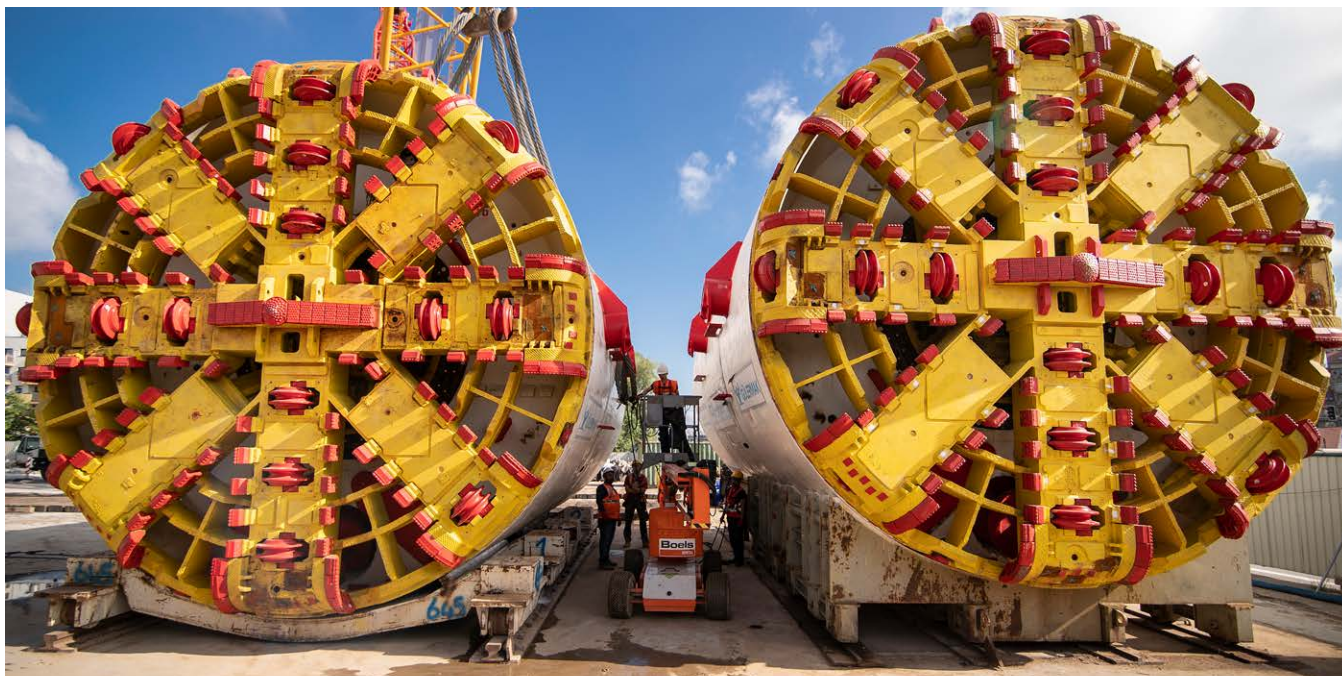
Maszyny TBM pracujące przy budowie drugiej linii metra w Warszawie / fot. Metro Warszawskie
